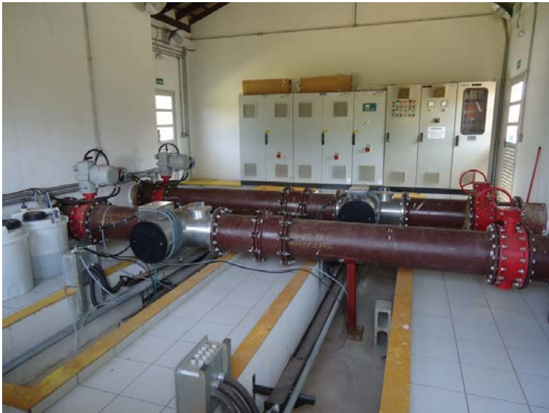
Figura 15 – Desinfecção por UV: ETE Águas da Serra – FOZ DO BRASIL – Limeira - SP
