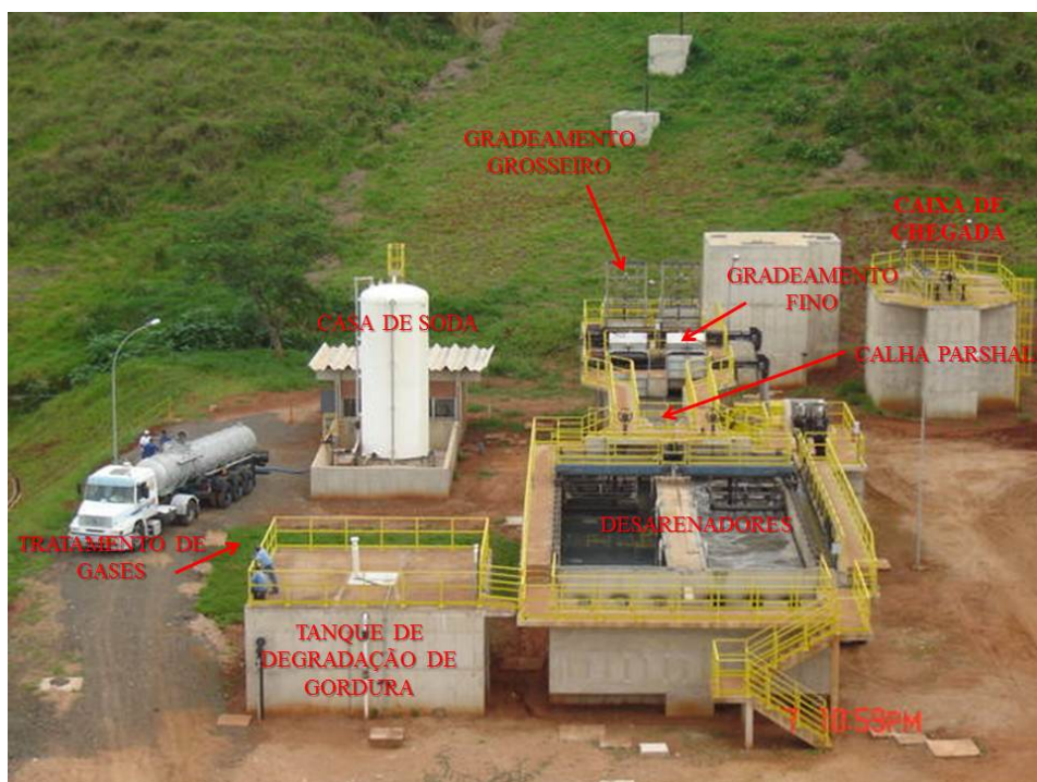
Figura 5 – Tratamento Preliminar – ETE Monjolinho – SAAE-São Carlos (Capacidade: 258.000 habitantes).
