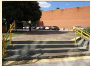
Ausência de corrimão central e piso tátil fora do padrão (menos de 30 cm antes do obstáculo), ocasionando impacto com os degraus ou queda do portador de deficiência visual.
